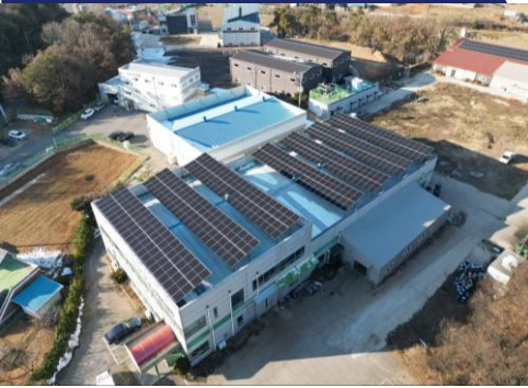
KJT 태양광 발전소(184.8kW)
